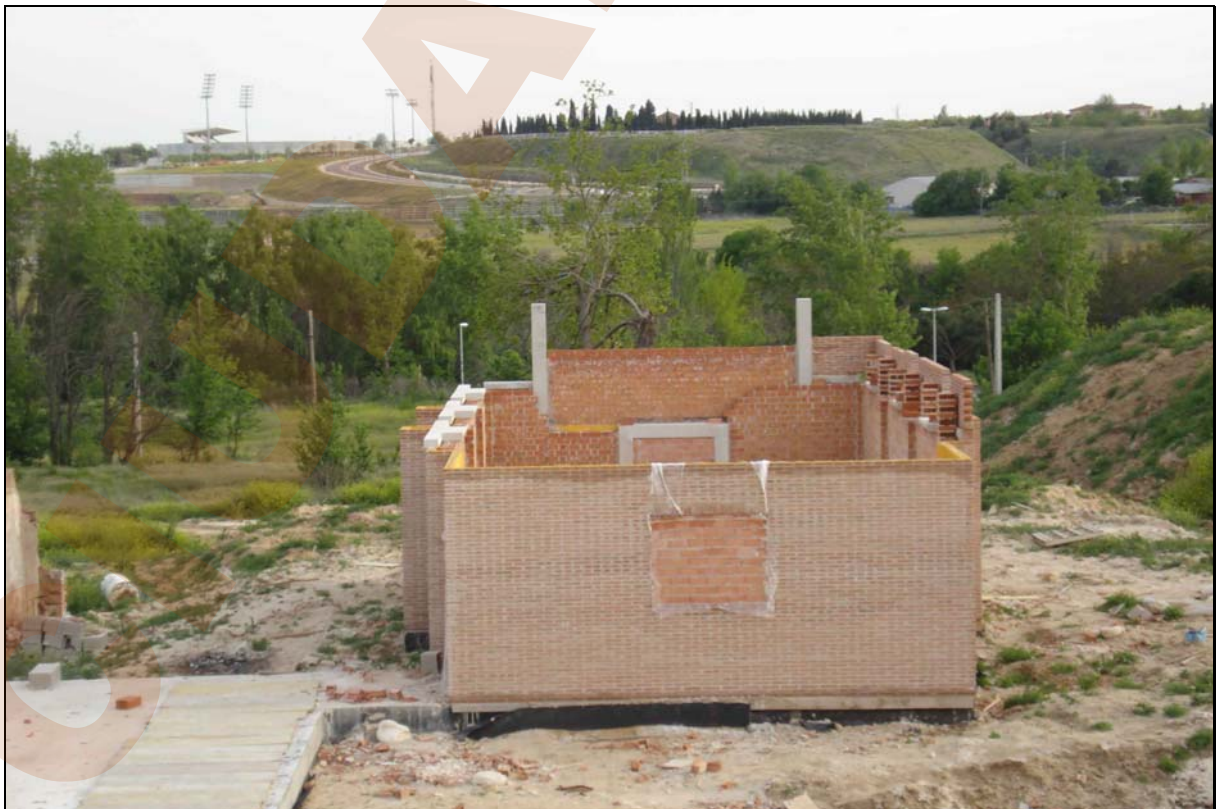
A pesar de no tener licencia para construir, se está edificando en la finca de la Mora
